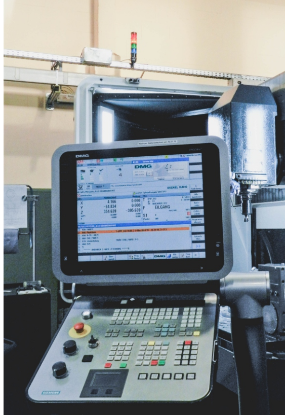
Die Signalsäulen wurden oberhalb der Maschinen montiert und sind auch aus der Ferne gut sichtbar
