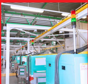
Auf jeder Maschine befand sich bereits eine WERMA-Signalsäule, welche um ein SmartMONITOR-Modul ergänzt wurde.
