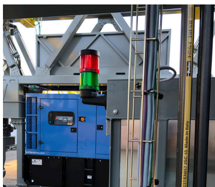
Aan elke schakelkast is een opvallende KombiSIGN-signaaltoren bevestigd.
